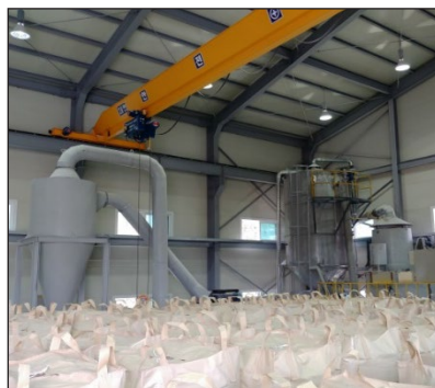
생산 공장 내부 전경
